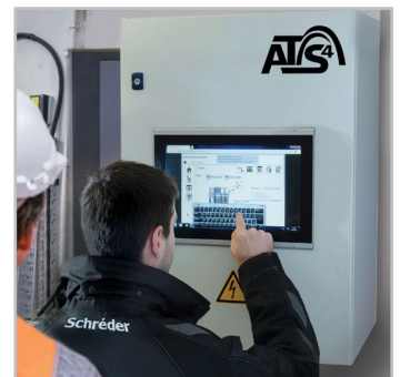
Compatible avec les systèmes de gestion de l'éclairage tunnel à distance, permettant une réponse rapide aux incidents et aux conditions changeantes.
